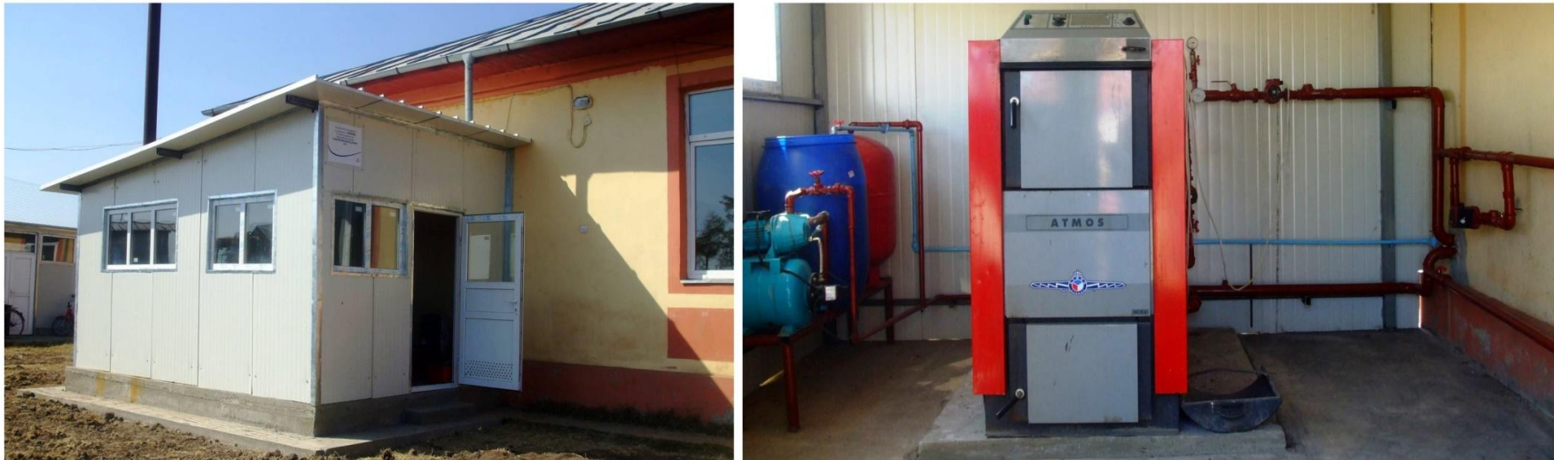
Foto: Centrala termica scoala, comuna Răscăeți -Sursa: Imagini puse la dispozitie de primarie
